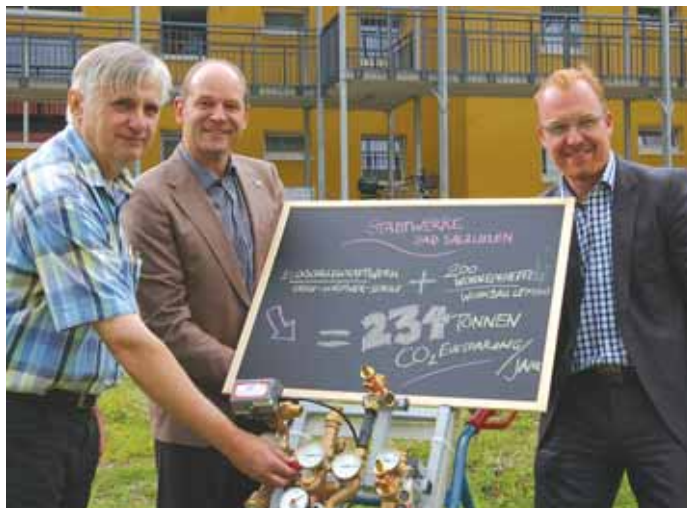
(v. l.): Hubert Pohlmann (Stadt Bad Salzuflen), Thorsten Kleinebckel (Wohnbau Lemgo) und Volker Stammer (Stadtwerke Bad Salzuflen) zeigen wie wenig Platz eine Wärmeübergabestation im einzelnen Objekt benötigt.
